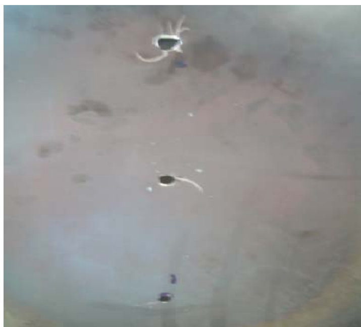
Σχήμα 4.16 Σφάλμα στο εσωτερικό τοίχωμα
