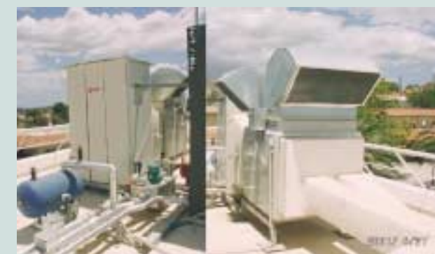
Ηλιοβοηθούμενη αντλία θερμότητας αέρα νερού για κλιματισμό του ορόφου(θέρμανση ψύξη).
