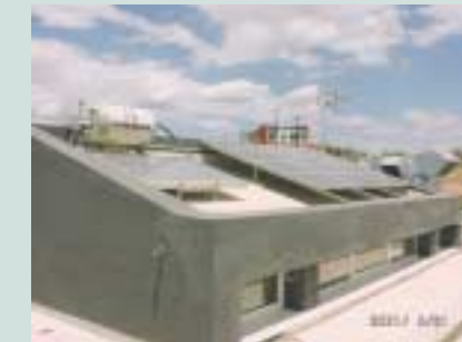
Φ/Β 600W στην κεκλιμένη οροφή του κτιρίου
