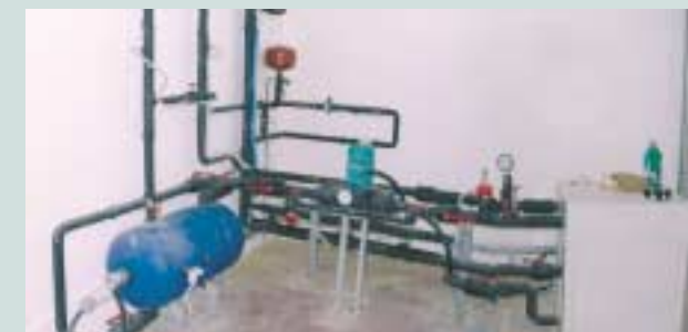
Γεωθερμική αντλία θερμότητας νερού νερού για κλιματισμό του ισογείου (θέρμανση ψύξη).
