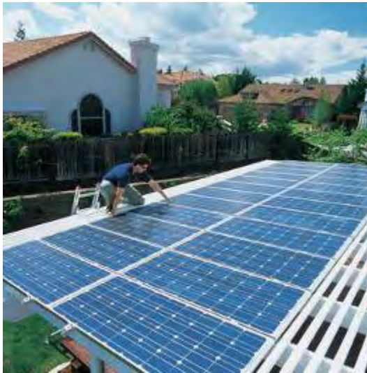
Εφαρμογή φωτοβολταϊκών σε σκέπαστρο
