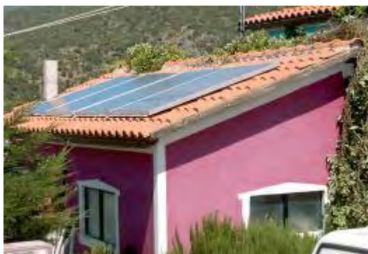
Εφαρμογή φωτοβολταϊκών σε κεραμοσκεπή εξοχικής κατοικίας
