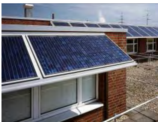
Φωτοβολταϊκά σε ρόλο σκιάστρων
