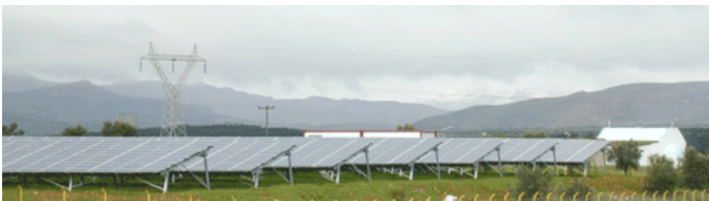
Ηλιακός σταθμός ηλεκτροπαραγωγής στην Κρήτη
